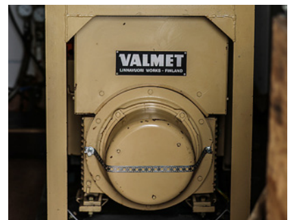
Deze generator is slechts 30 jaar gebruikt.
